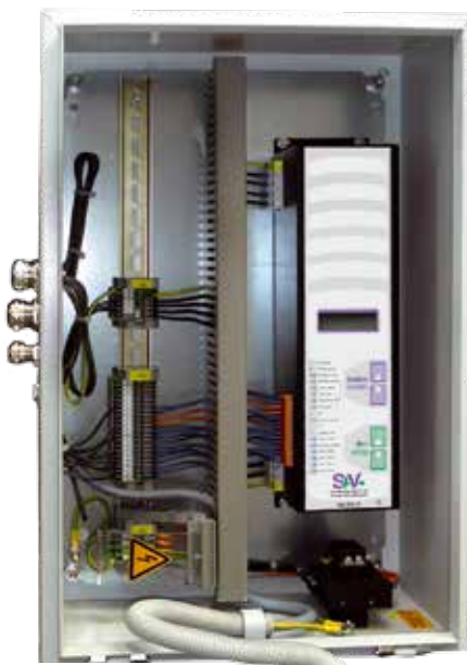
Steuerung im Schaltkasten
